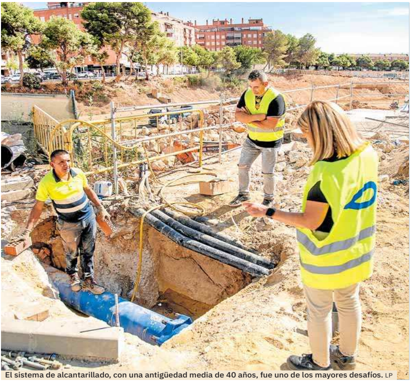
El sistema de alcantarillado, con una antigüedad media de 40 años, fue uno de los mayores desafíos. LP
